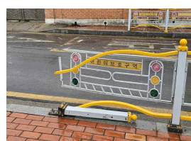
어린이 안전 (안전펜스 파손)
