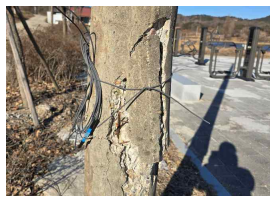
해빙기 (시설물 파손)
