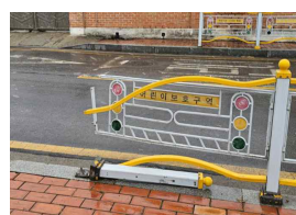
어린이 안전 (안전펜스 파손)
