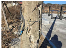
해빙기 (시설물 파손)
