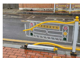
어린이 안전 (안전펜스 파손)
