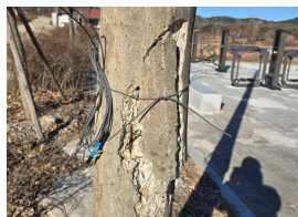
해빙기 (시설물 파손)
