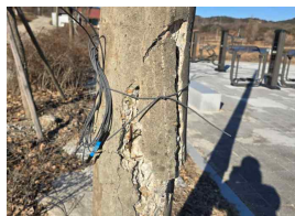
해빙기 (시설물 파손)
