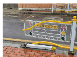
어린이 안전 (안전펜스 파손)
