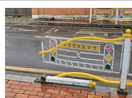
어린이 안전 (안전펜스 파손)
