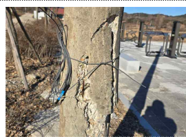
해빙기 (시설물 파손)
