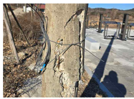
해빙기 (시설물 파손)
