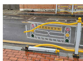
어린이 안전 (안전펜스 파손)
