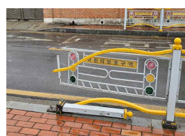
어린이 안전 (안전펜스 파손)
