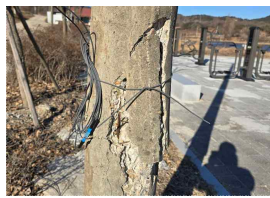
해빙기 (시설물 파손)
