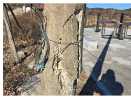
해빙기 (시설물 파손)
