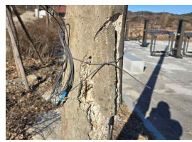
해빙기 (시설물 파손)
