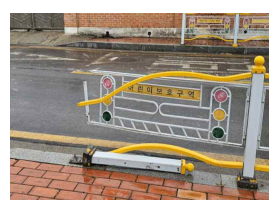
어린이 안전 (안전펜스 파손)
