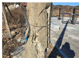
해빙기 (시설물 파손)
