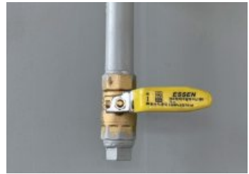
미사용 배관 마감 조치
