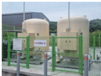
대형 가스공급시설 보호 및 출입통제
